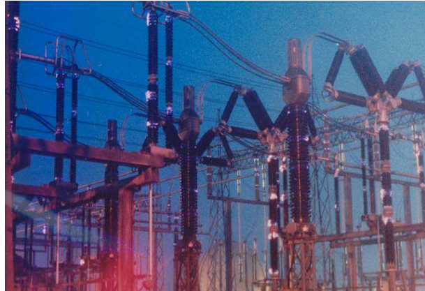
[그림 3-109] 옥외개방형공기절연방식 옥외변전소
