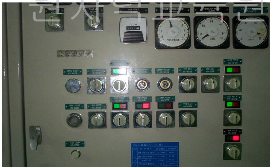
[그림 3-135] 비상디젤발전기 현장 제어반
